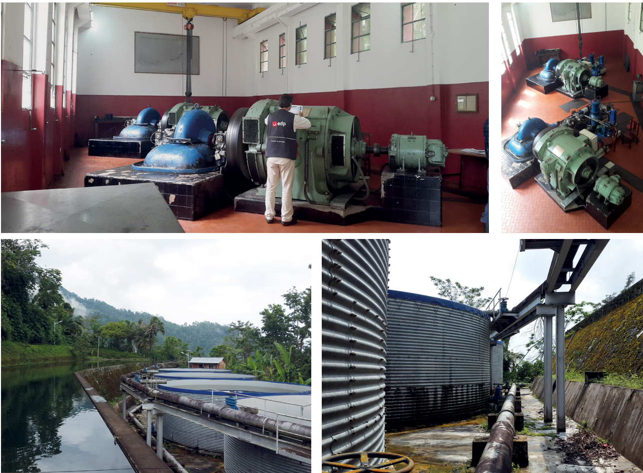
Figura 39 Fotografias da Central Hidroeléctrica do Contador / Fonte: ALER, 2016 Figure 39 Photos of the Contador Hydropower plant / Source: ALER, 2016
