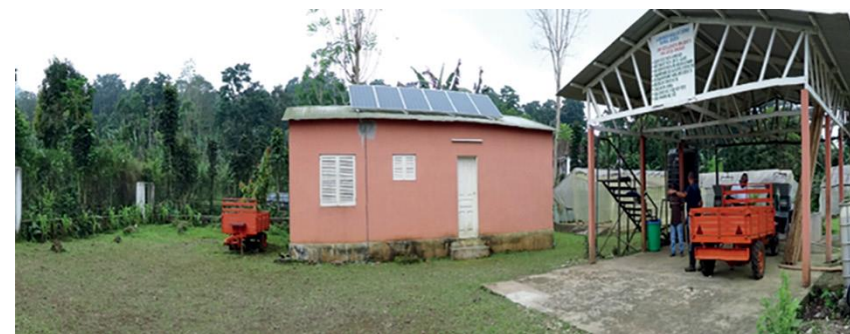
Instalação PV na Cooperativa de café biológico da comunidade de Bem-posta realizada no âmbito do PAPAC / Fonte: DGRNE, 2014
