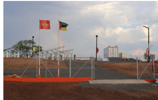
Central Solar de Chintolo (100kW)-Tete
