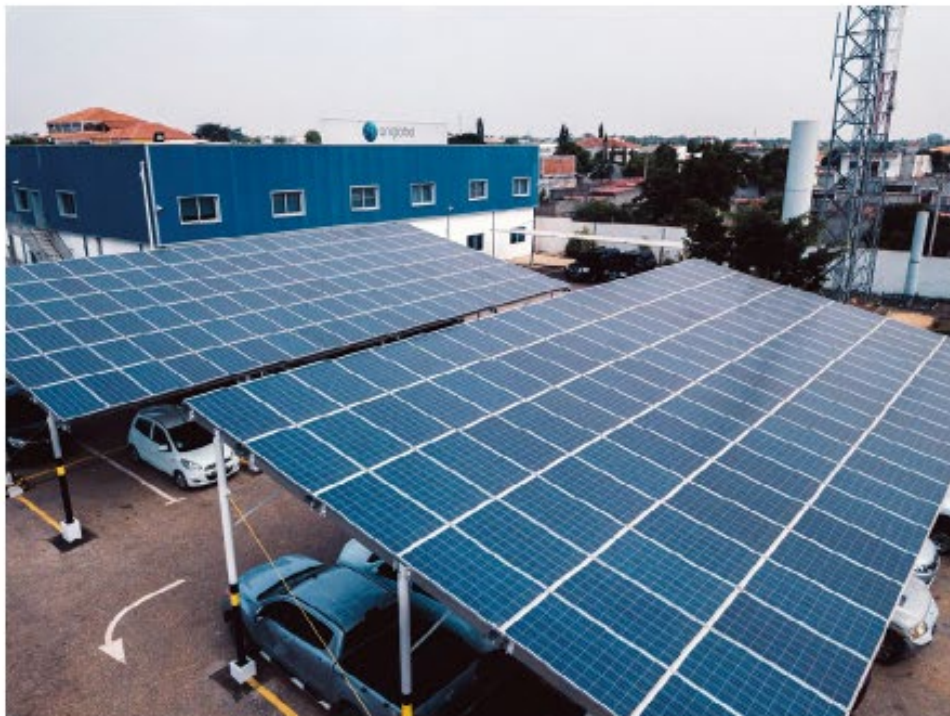
Figura 41 Central Solar no parque de estacionamento do Estaleiro da Anglobal / Fonte: Anglobal, Comunicação Pessoal, Junho de 2022
